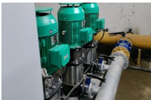
Tratamento de água e esgoto
